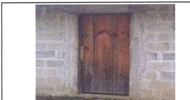
Foto 5: Se observa cambio de puerta de madera por metal.
